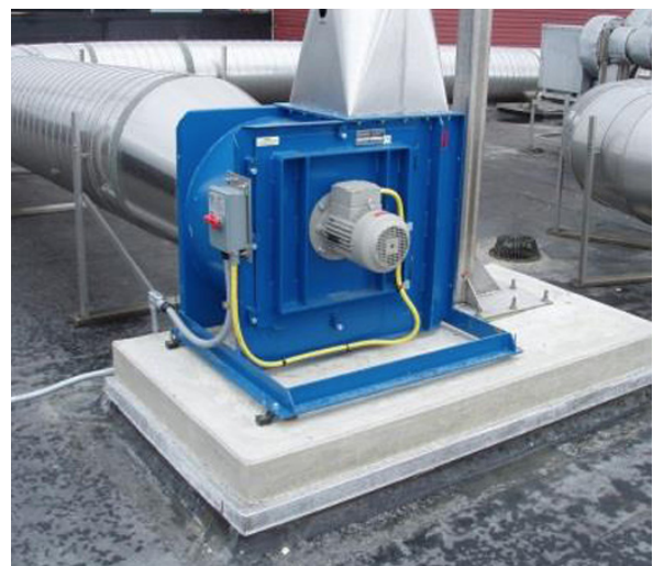
Fläck placerad på taket
